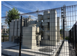
省エネ設備への更新 (小牧本社工場)
