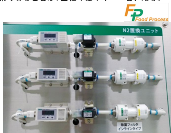
Fig. 7 窒素置換装置の配管部品
