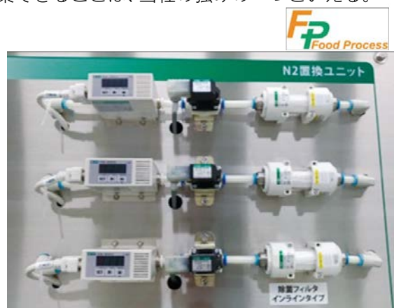
Fig. 7 窒素置換装置の配管部品
